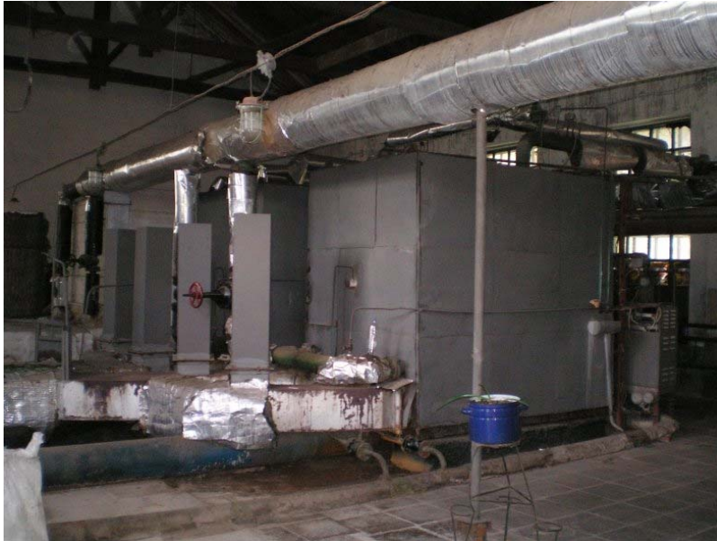
Kesselanlage I bis IV
